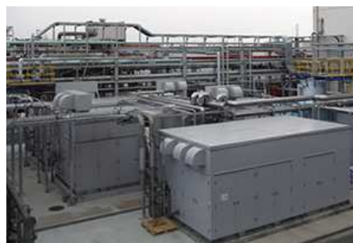
冷水用冷凍機
